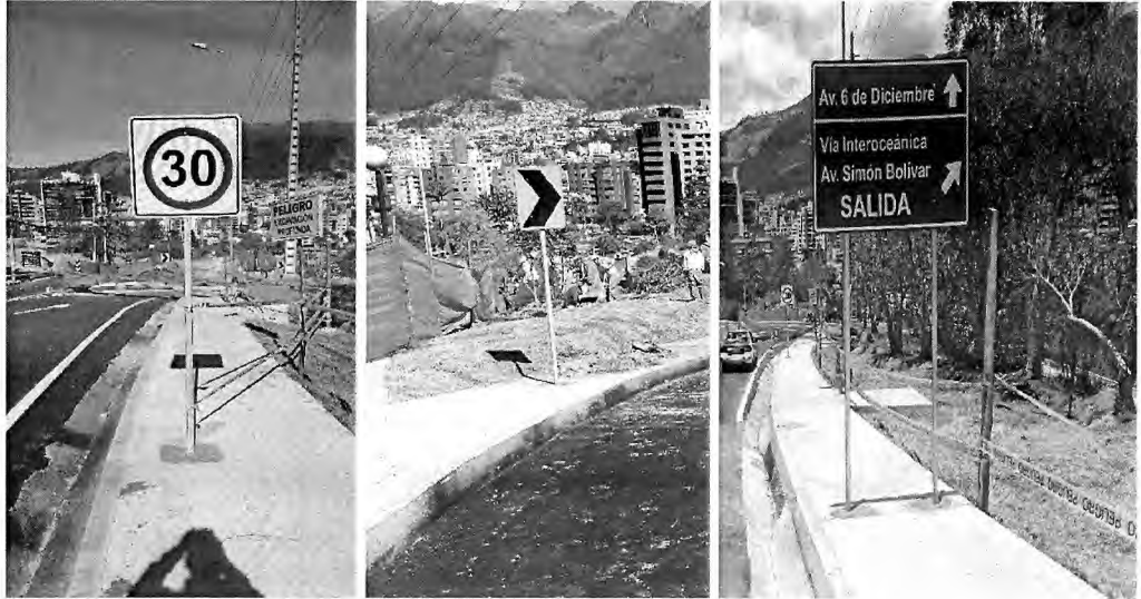
SEÑALIZACION VERTICAL PARA SEGURIDAD VIAL EN PASO PROVISIONAL
